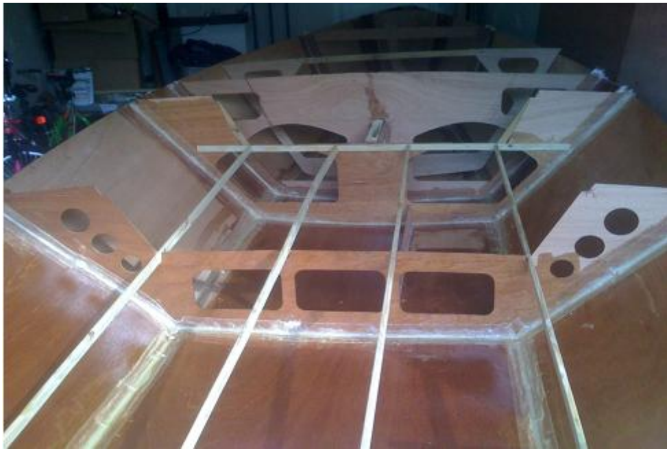
Стрингеры помещения кабины добавлены в надрезанные рамки. Внутренности замазаны, заклеены и загрунтованы эпоксидной смолой.
